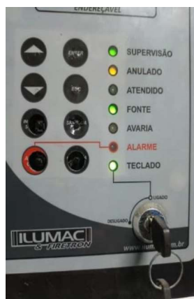
Fig. 1 - Necessidade de troca da película externa e reconfiguração geral da Central
